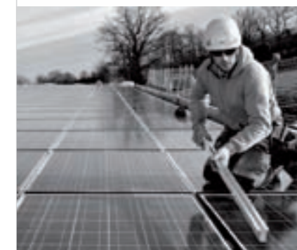
Près de 1700 m 2 de panneaux photovoltaïques installés sur la nouvelle usine HQE
